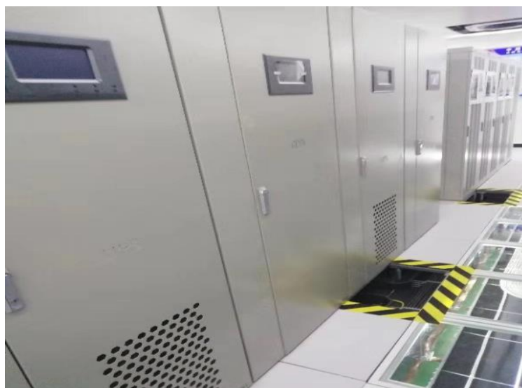
图 58 成都地铁 5 号线某站点电源系统
